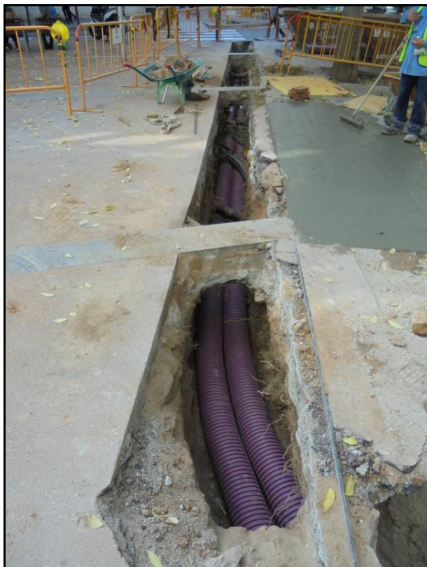
Fotografia 9: Col·locació dels tubulars a un tram de la rasa de Rec Comtal.
